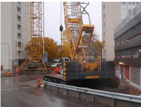
Kuva 2. Tela-alustainen ristikkopuominosturi. (Kuva: Voller Oy)
